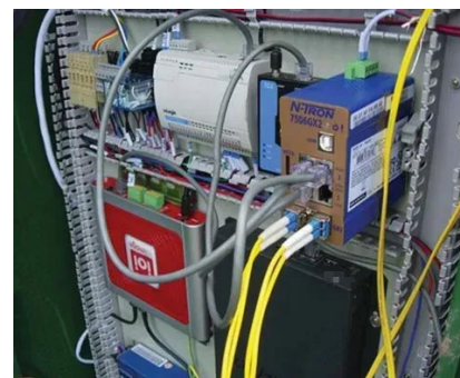
每个监控点都装有一个设备箱，安放探测器、警笛、闪光灯频闪报警器和高分辨率摄像机等控制设备。所有组件都通过 N-Tron 7506GX2 交换机接入网络中。
